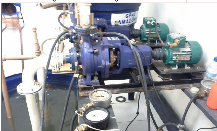
Figura 2-Bomba centrífuga e manômetros de medição
