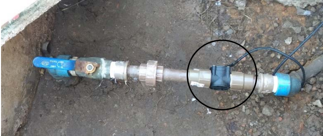
Fig. 7. Equipamento instalado na tubulação de água da residência.
