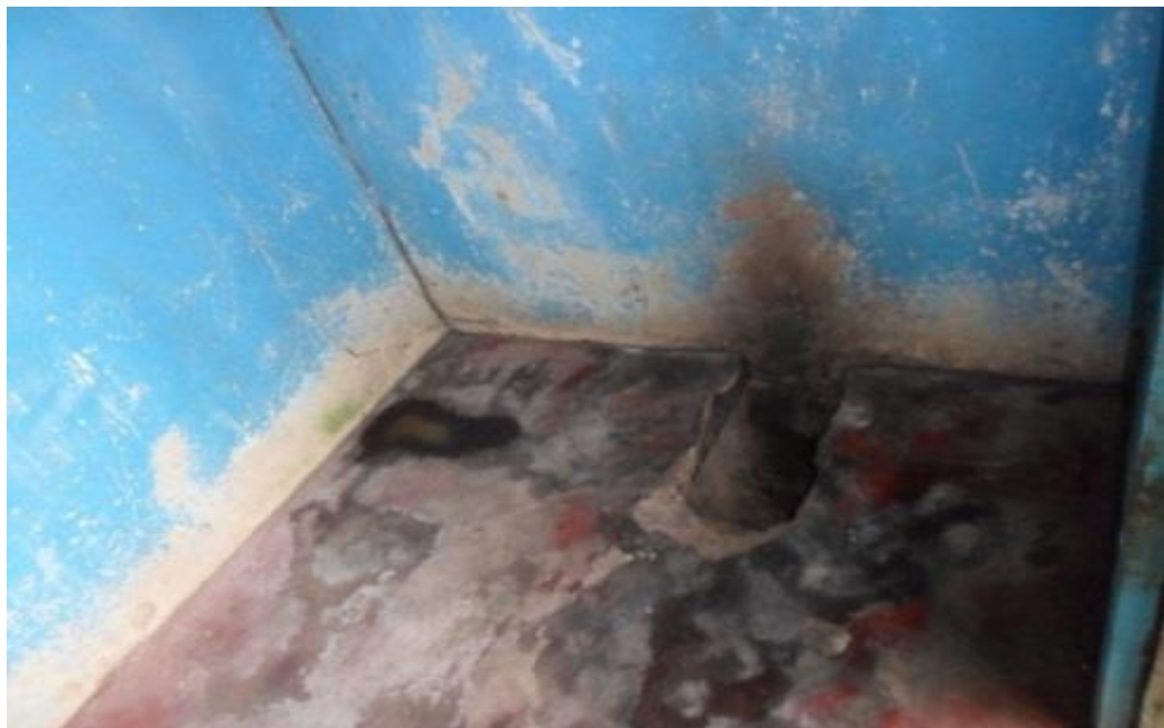
Figura 5: Banheiro da Escola Santo Antônio no rio Moju-miri
